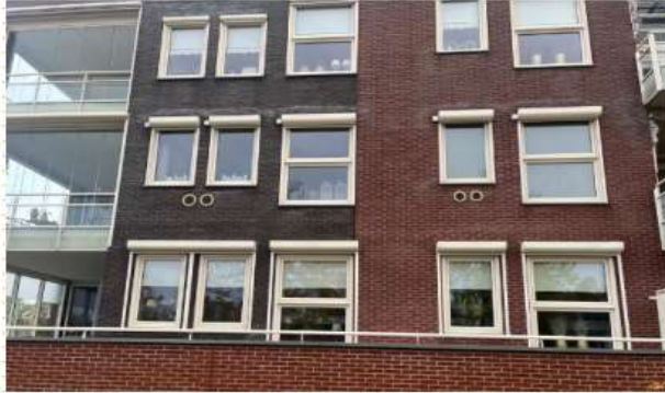
Gevel doorvoeren voor monoblock airco 's (afvoeren door woonkamer naar balkon)
