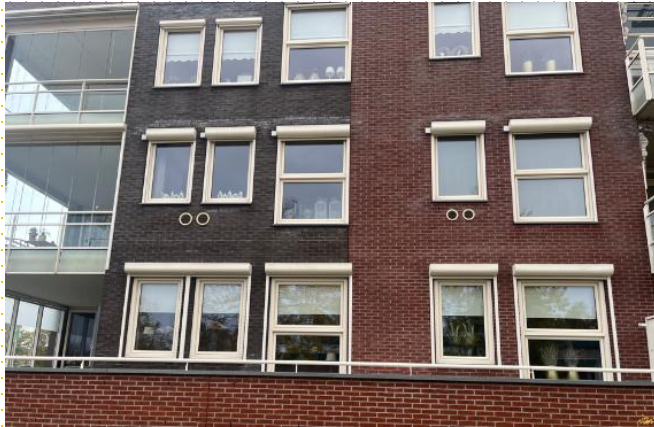
Gevel doorvoeren voor monoblock airco 's (afvoeren door woonkamer naar balkon)
