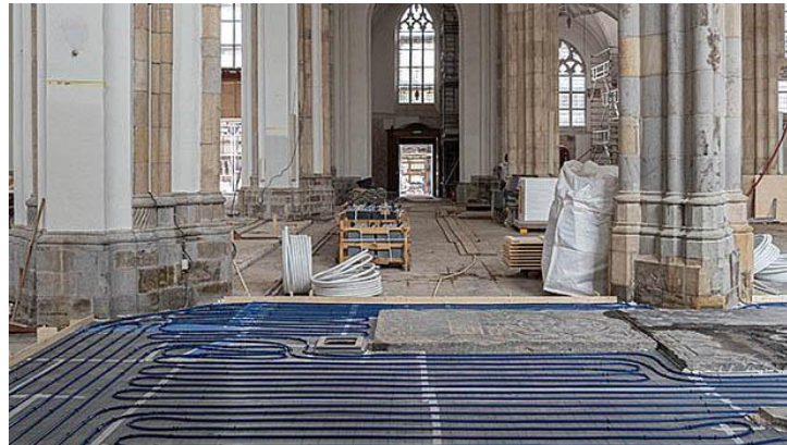
(Hybride) warmtepomp met vloerverwarming & ventilatoren
